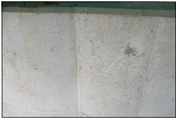
교각 코핑부 균열(P2)
