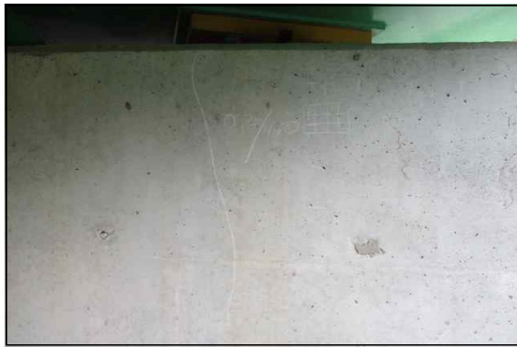
교각 코핑부 균열(P2)
