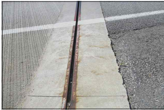
신축이음 후타재 균열(A1)
