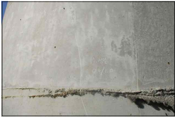
교각 기둥부 균열(P1)
